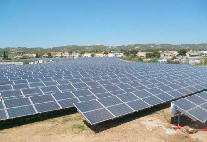
Ci-contre : la centrale photovoltaïque UEM de La Fare les Oliviers (Bouches-du-Rhône).
